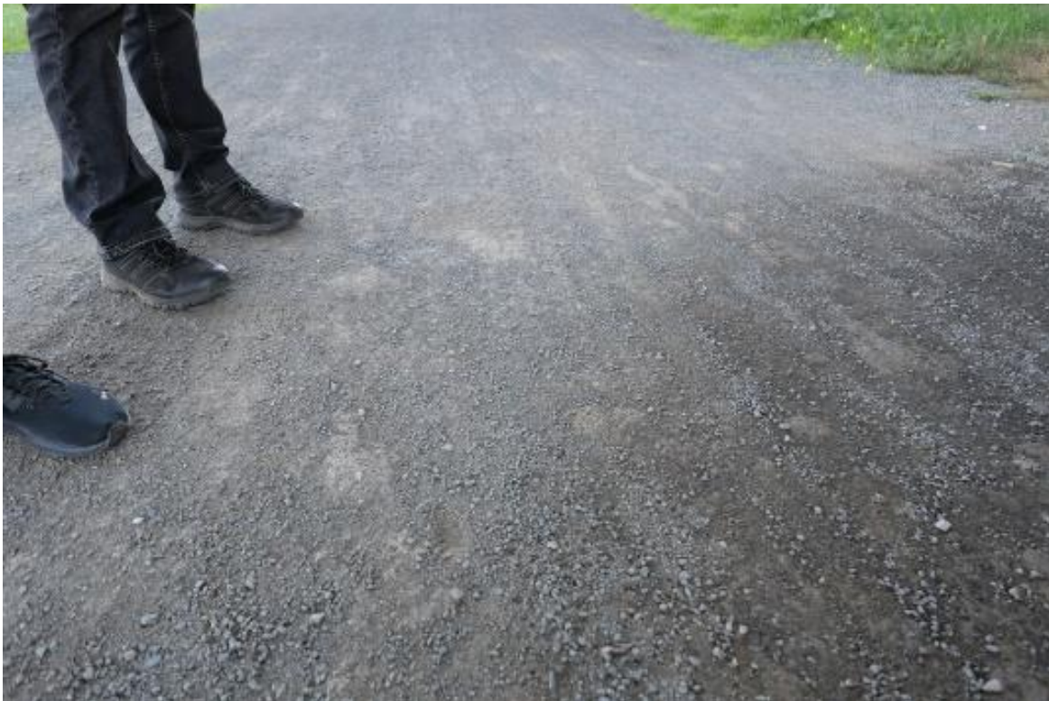
Abbildung 5 Radweg unter Eisenbahnbrücke mit einigen Verfestigungen
